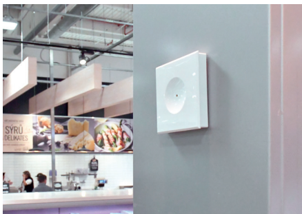
Temperatur- und Feuchtigkeitsüberwachung im Verkaufsraum (LS1).
